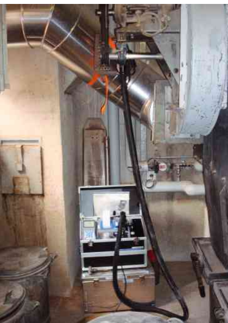
Abgasmessung im Kamin einer automatischen Holzfeuerung.
