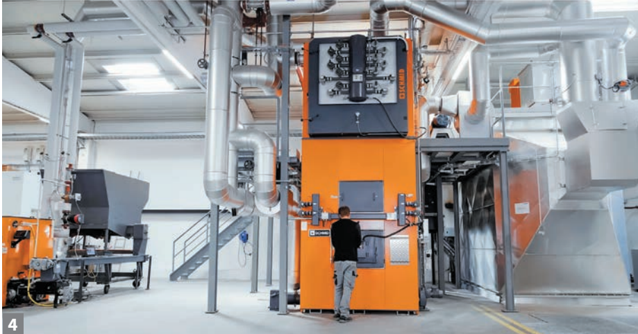
4 Holzkessel mit adaptiver Feuerungsregelung von Schmid AG. [Spörl & Vogel 2022] in [1]
