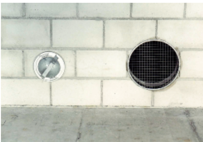
Bild 19 / figure 19 Befüllungsstützen für Pellets und Entlüftungsöffnung für Lagerraum.
