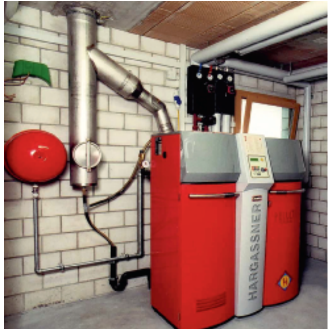
Bild 18 / figure 18 Pelletkessel im Heizraum (Hargassner).
