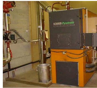
Chaudière automatique au bois moderne, photo Schmid
