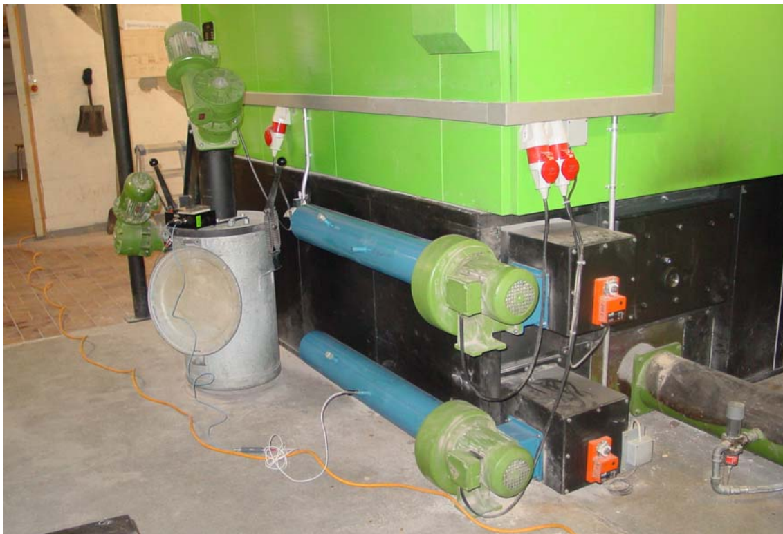
Bild 8.1: Zuluftventilatoren mit vorgeschalteten Rohren zur Bestimmung der Zuluftvolumenströme mit Hilfe eines Flügelradanemometers.
