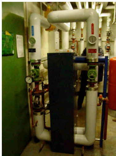
Unterstation im Landihaus
