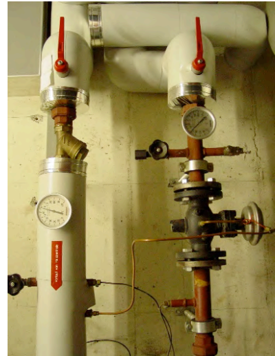
Druckregler der Übergabestation
