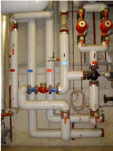
Fernleitungsabgang mit Wärmezähler
