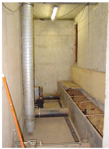
Luftabsaugrohr im Zylinderraum
