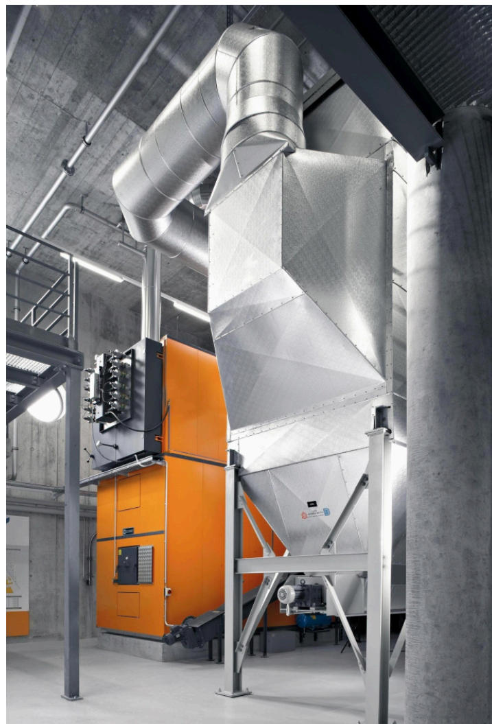
Heizzentrale mit 2,4-MW-Vorschubrostfeuerung und Elektroabscheider.
